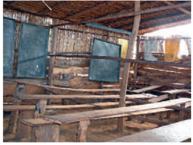
Schulgebäude das dringend erneuert werden sollte
